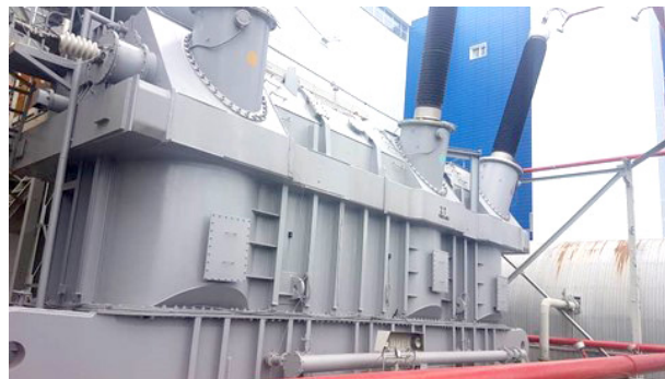
Рис. 5. Внешний вид трансформатора со стороны ВН
