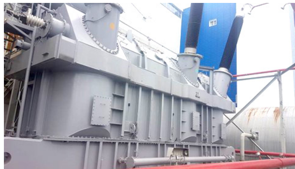
Рис. 5. Внешний вид трансформатора со стороны ВН
