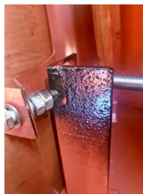
Рис. 4. Вероятное место дефекта (т. 24, 25, 26)
