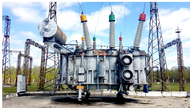
Рис. 1. Внешний вид автотрансформатора АТДЦТН-63000/220
